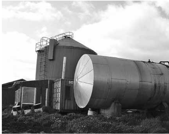
デンマーク・ユトランド半島のバイオガス発電プラント（写真：小澤祥司氏提供）
